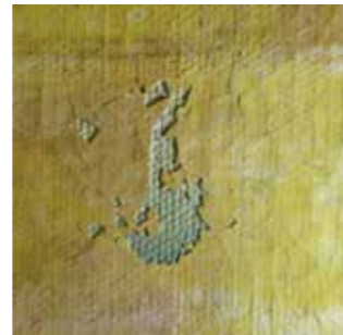
写真6 剥落部分(拡大)
