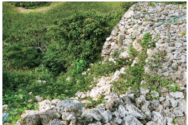
写真 27. 面石が崩壊した久米島具志川グスクの石積み
