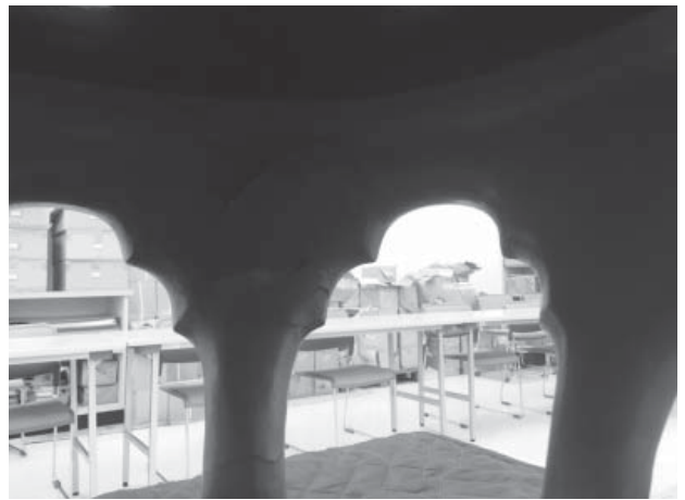
写真19 塗膜剥離の写真（脚の裏側）
